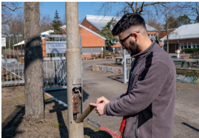
Prüfender Blick in den Anschlussraum einer Leuchte.
