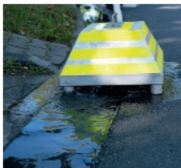
Das Wasser wird kontrolliert abgeleitet.
