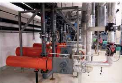
Wärmetauscher sorgen für die Beckenwassererwärmung
