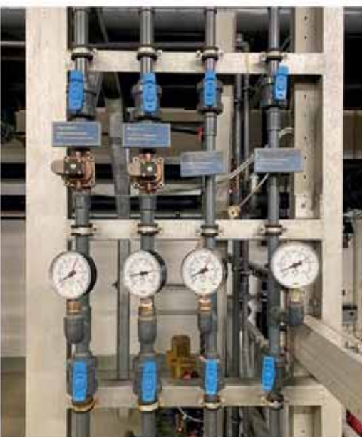
Druckmanometer der Treibwasserpumpen regeln die Chlordosierung.
