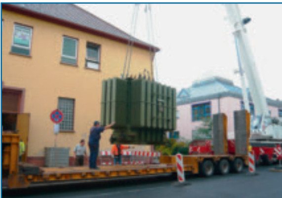
Bloß nicht fallen lassen! Der Umwandler, im Volksmund Transformator genannt, wiegt trocken 20 Tonnen. Damit haben die Spezialisten der Stadtwerke alle Hände voll zu tun.
