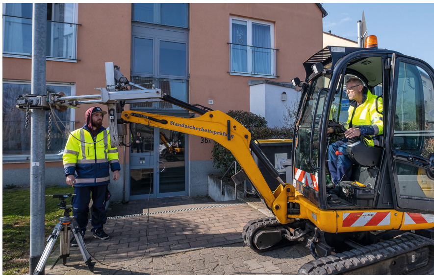
Ein Spezialfahrzeug überträgt genau bemessene Kräfte auf den Lichtmast. Das Messgerät im unteren Bereich misst die Schwingungen und überträgt diese direkt in ein Auswertungssystem.
