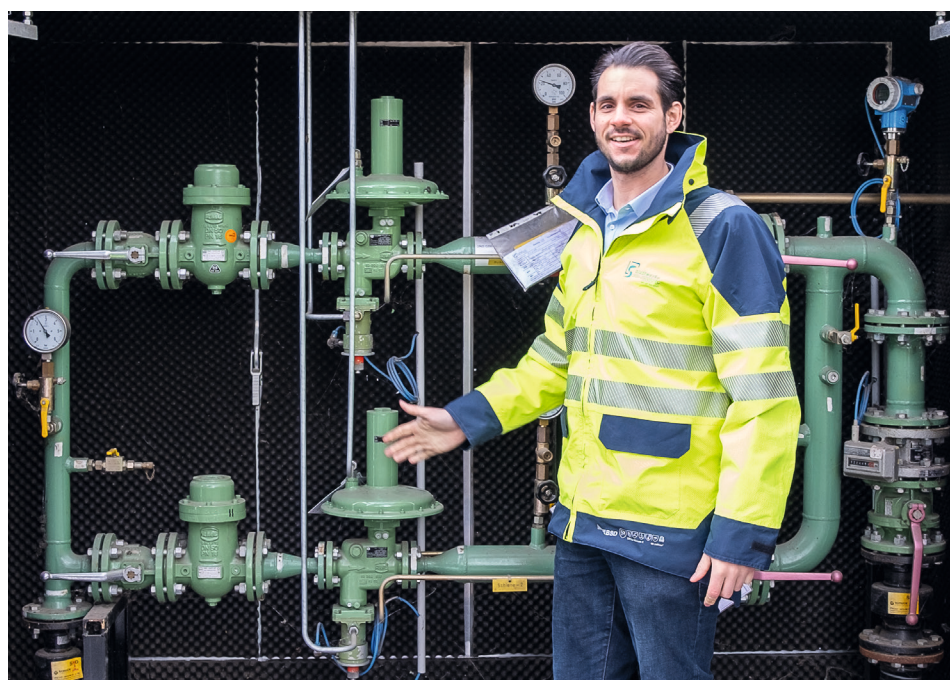
In einer Gasdruckregelstation wird der Hochdruck in Niederdruck abgewandelt, der die Haushalte versorgt.
