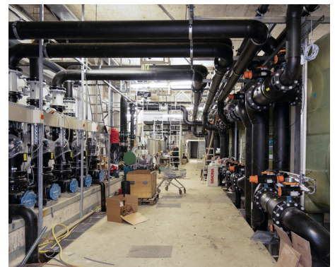
Ein Blick in den Technikeller.
