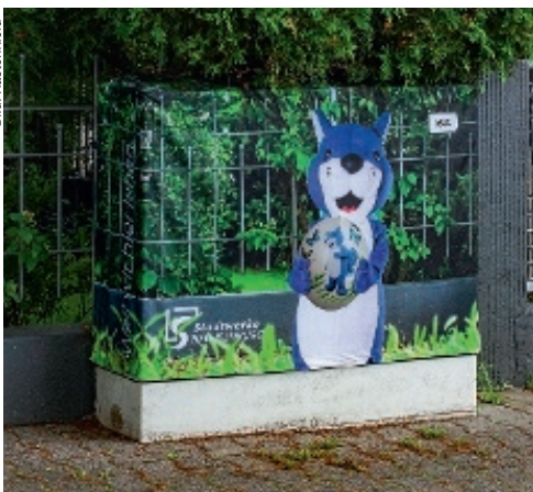
Das Kastenkleid verhüllt den Stromverteilerkasten.
